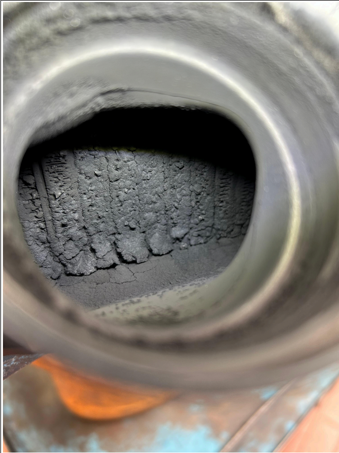
Charge Air Cooler 1.JPG
